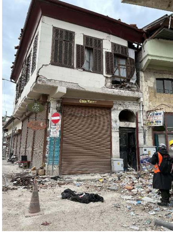
Şekil 48. Orta hasarlı bir yapı örneği
