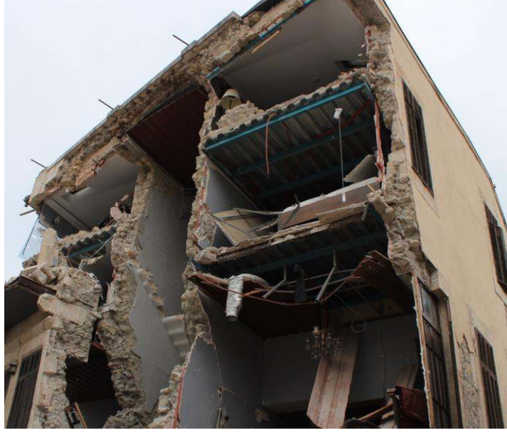
Şekil 63. Çelik I kirişlerin özgün yapım sistemine tam olarak entegre edilememesi sonucu oluşan cephe bazında yıkım (ODTÜ TAÇDAM, 2023)
