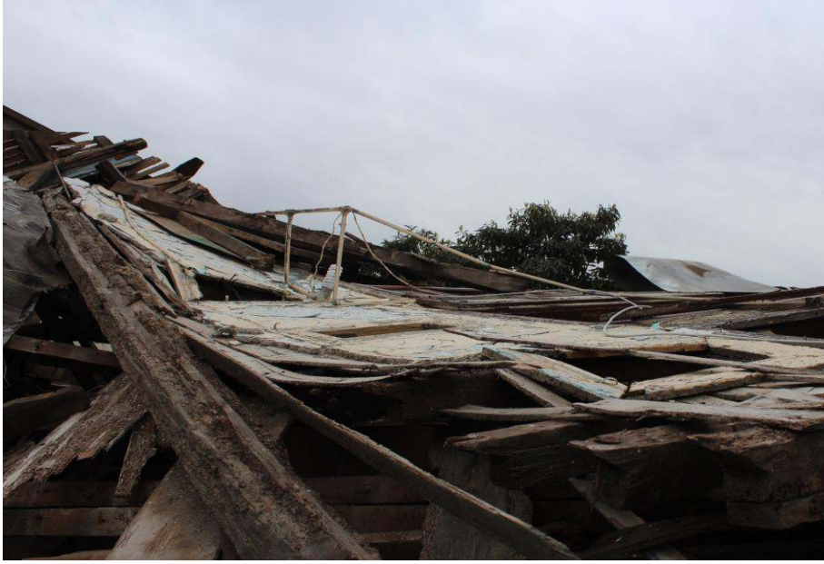
Şekil 62. Ahşap yapı malzemesindeki çürümeler (ODTÜ TAÇDAM, 2023)
