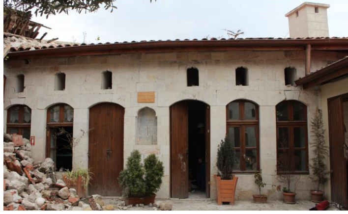
Şekil 47. Hafif hasarlı bir yapı örneği
