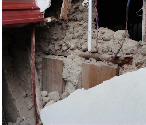
Şekil 57. Hatılların süreksiz kullanıldığı, bağ kirişlerinin olmadığı ve harcın bağlayıcı özelliğini yitirdiği yığma taş duvar örgüsü (ODTÜ TAÇDAM, 2023)
