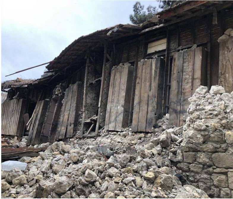
Şekil 60. Yığma taş duvarın tamamen yıkılıp içerdeki ahşap niş ve gömme dolapların kaldığı yapı örneği (ODTÜ TAÇDAM, 2023)
