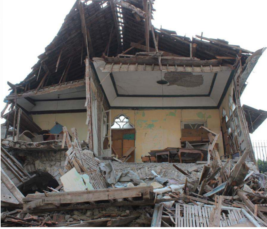
Şekil 61. Depremden büyük ölçüde zarar görmüş tekne tonozlu ahşap karkas sistemi ile inşa edilmiş yapı (ODTÜ TAÇDAM, 2023)
