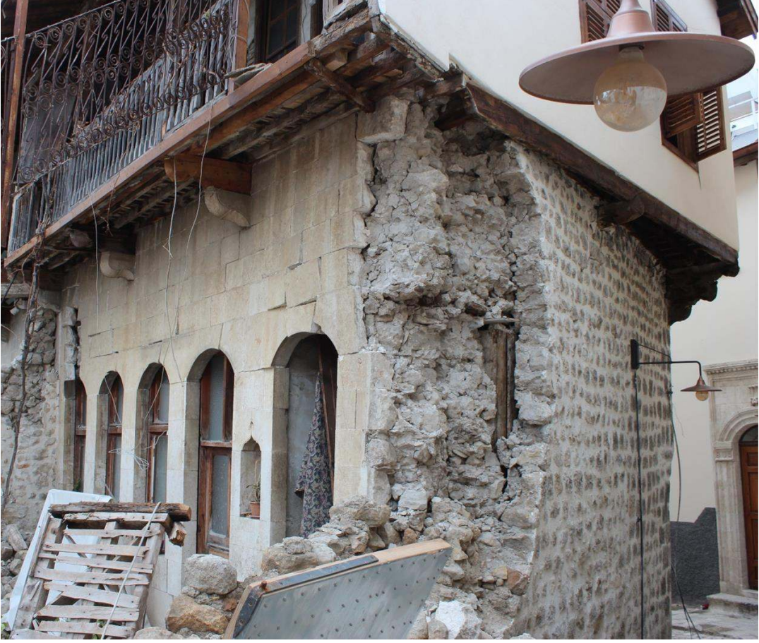
Şekil 58. Niş ve gömme duvar kullanımından duvarın stabilitesinin zayıfladığı yığılma taş duvar örgüsü (ODTÜ TAÇDAM, 2023)
