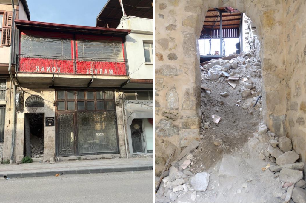
Şekil 65. Kurtuluş Caddesi üzerinde ön cepheden hasarsız görünen ancak içeri girildiğinde arka kısmının tamamen yıkıldığı saptanan bir yapı örneği (ODTÜ TAÇDAM, 2023)
