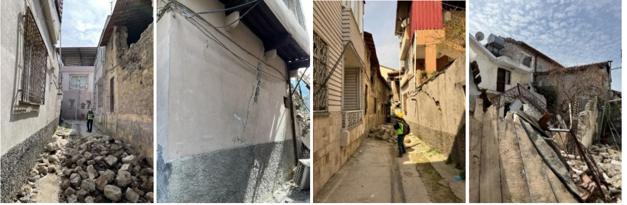
Şekil 41. Kamusal açık alanların çeperlerini oluşturan yapı ve avlu duvarlarının farklı risk seviyelerini gösteren görünümleri (ODTÜ TAÇDAM, 2023)
