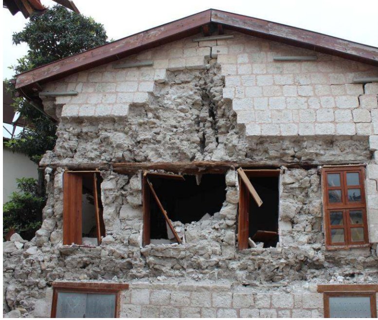
Şekil 59. Yatayda ve dikeyde destekleyici duvar ve döşeme olmaması sebebiyle hasar gören yığma taş duvar örgüsü (ODTÜ TAÇDAM, 2023)
