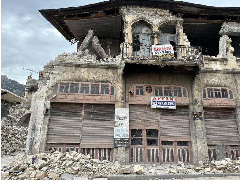
Şekil 49. Ağır hasarlı bir yapı örneği: Kurtuluş Caddesi üzerindeki Affan Kahvesi. Nitekim Bu yapının üst katının saha çalışmasının hemen ardından yaşanan artçı deprem sonucunda tamamen yıkıldığı öğrenilmiştir.
